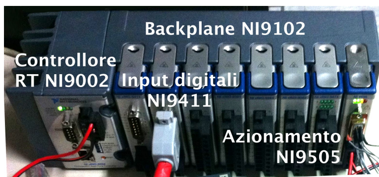
Figura 9.2: Foto del controllore National Instruments CompactRIO in funzionamento.
