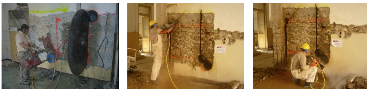
Figura 3.28 Preparazione del pannello con taglio della muratura e rifinitura manuale del pannello.
