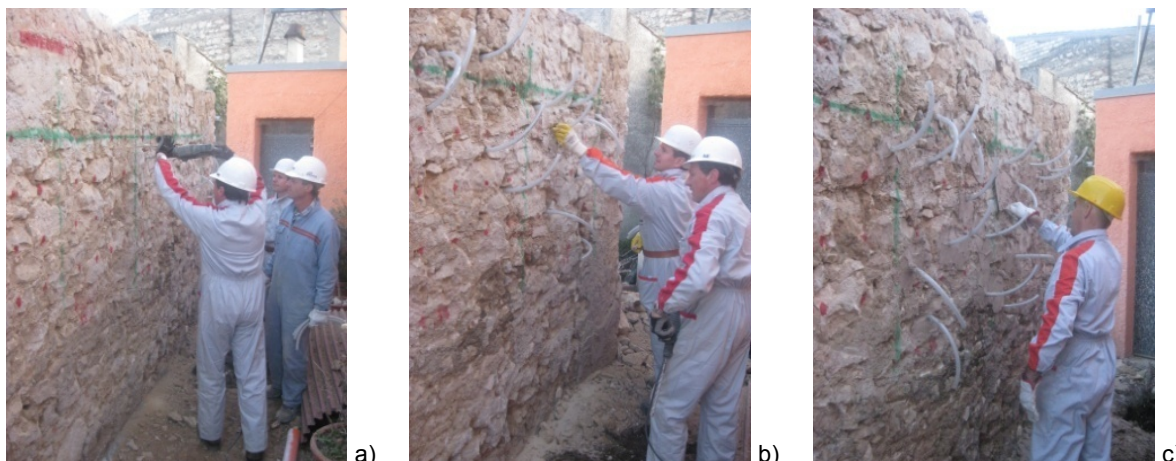
Figura 3.6 Realizzazione dei fori (a), Inserimento delle cannule (b) e stilatura dei giunti (c)
