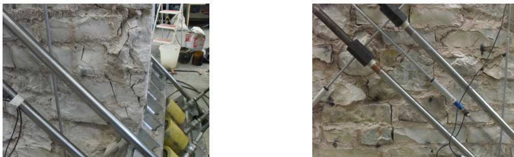
Figura 4.39 Muro A6 lesionato al termine della prova di compressione diagonale.
