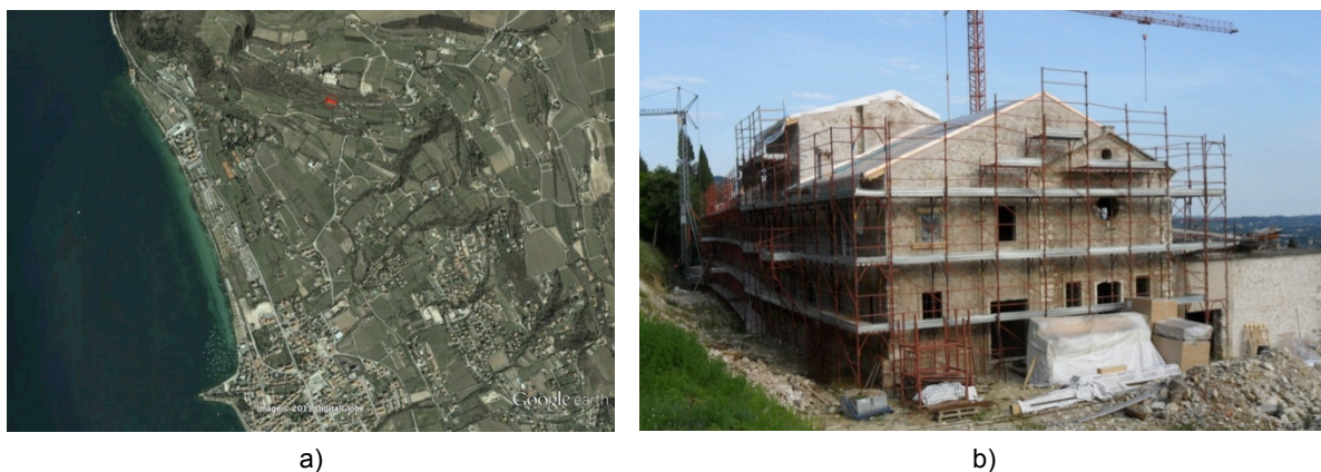
Figura 3.8 Inquadramento da satellite (a) (Google Maps, 2011) e una vista da ovest (b).
