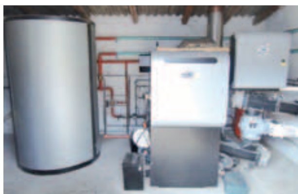
Esempio di centrale termica a cippato.
