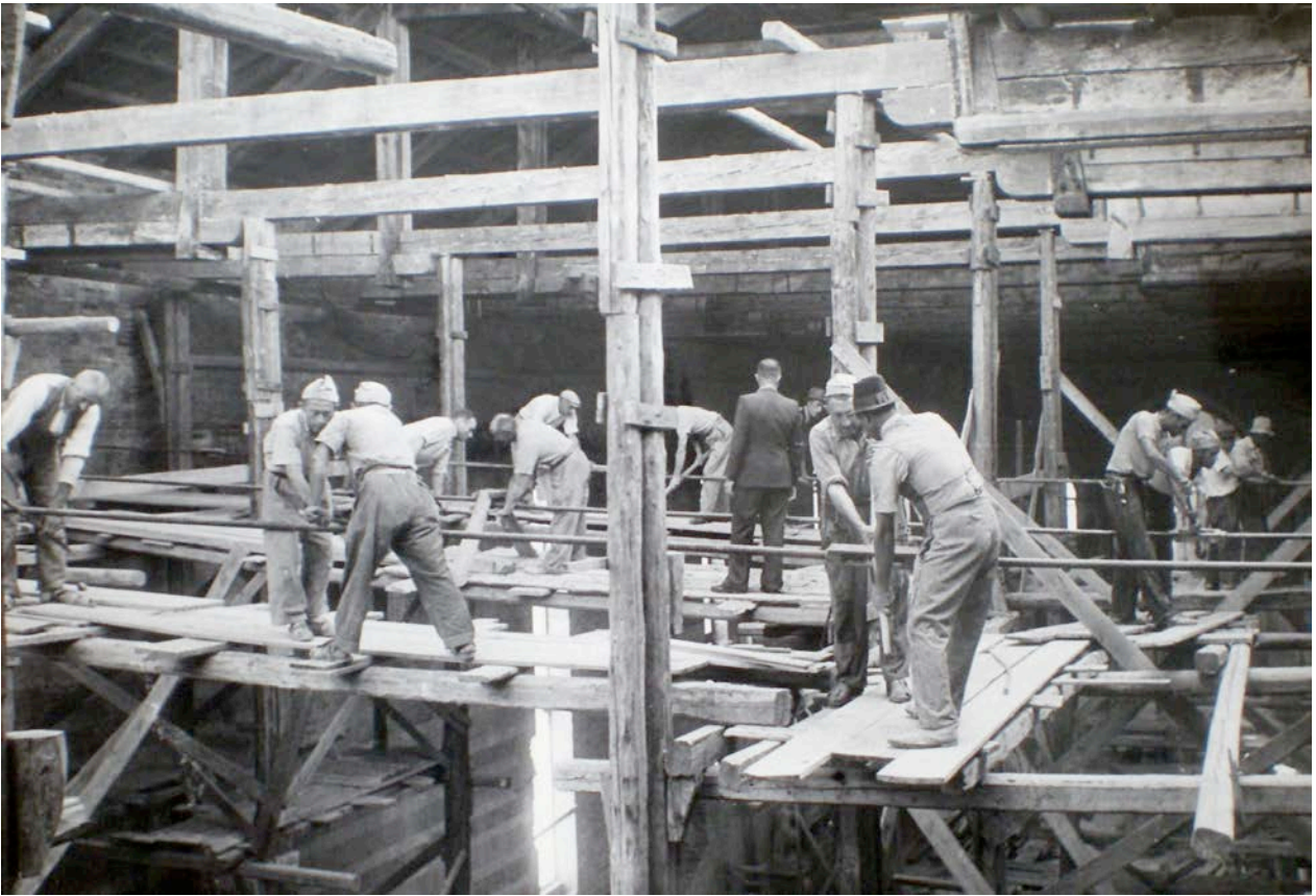
54. Gli operai girano i tiranti in ferro e i manicotti per far tornare a piombo le murature. Dopo questa procedura un'iniezione cementizia rinsalderà il muro ritornato al suo stato originario.
