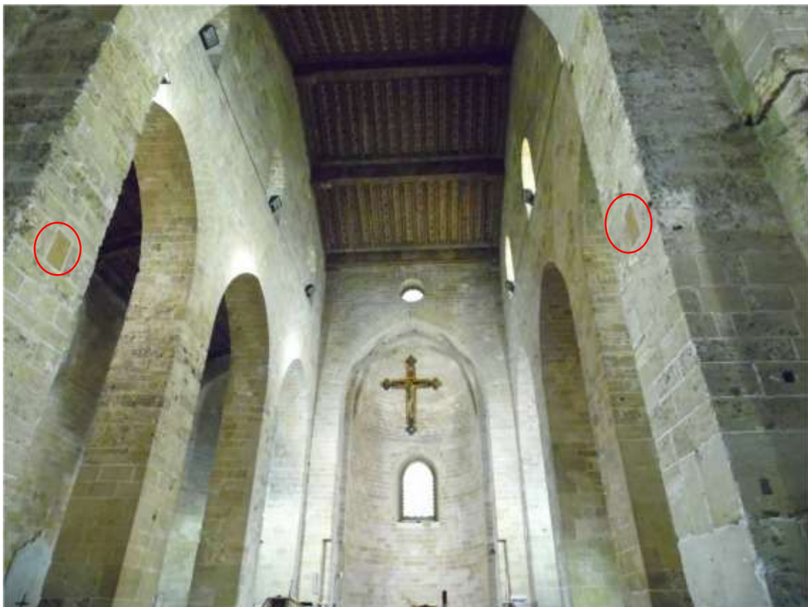
Fig. 309: Fori tampognati per l'alloggiamento della trave della croce, Palermo, Santo Spirito.
