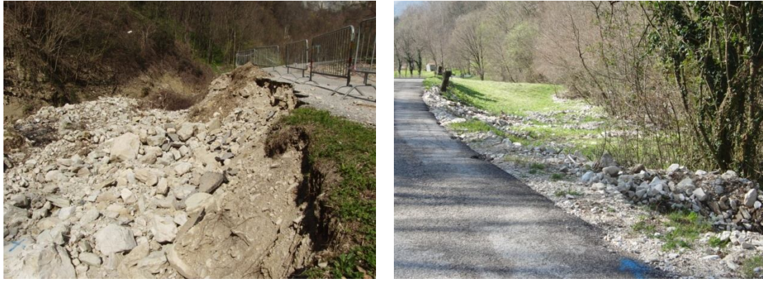
Fig. 4.7- 4.8: Erosione spondale in prossimità del primo tornante e deposito di materiale detritico.
