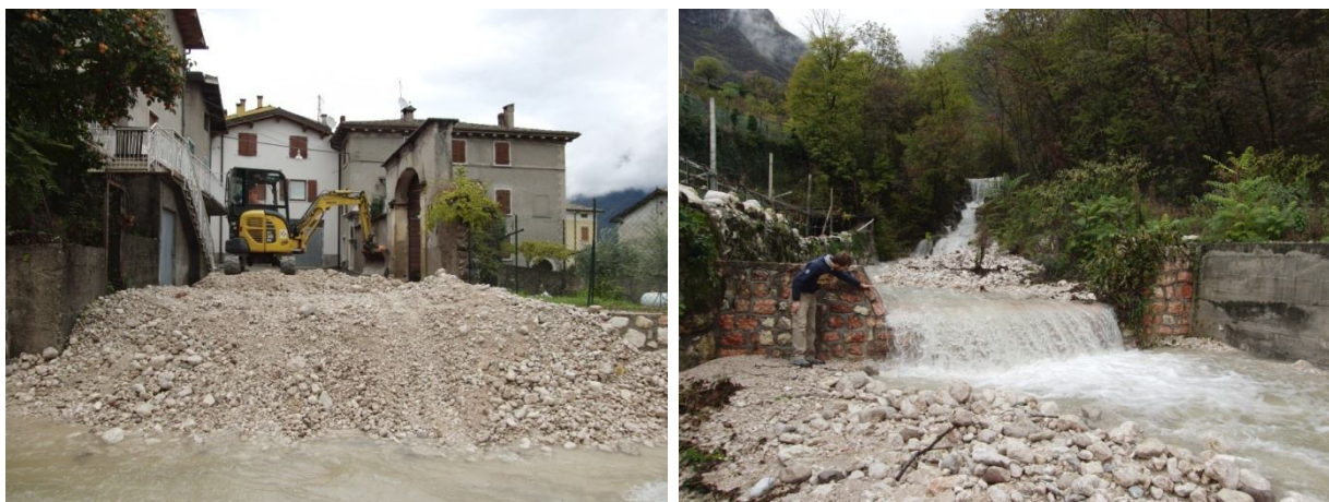
Fig. 3.54: Materiale depositato nel canale artificiale, relativo all'evento del 4-5 novembre 2012 sul Rio Secco
