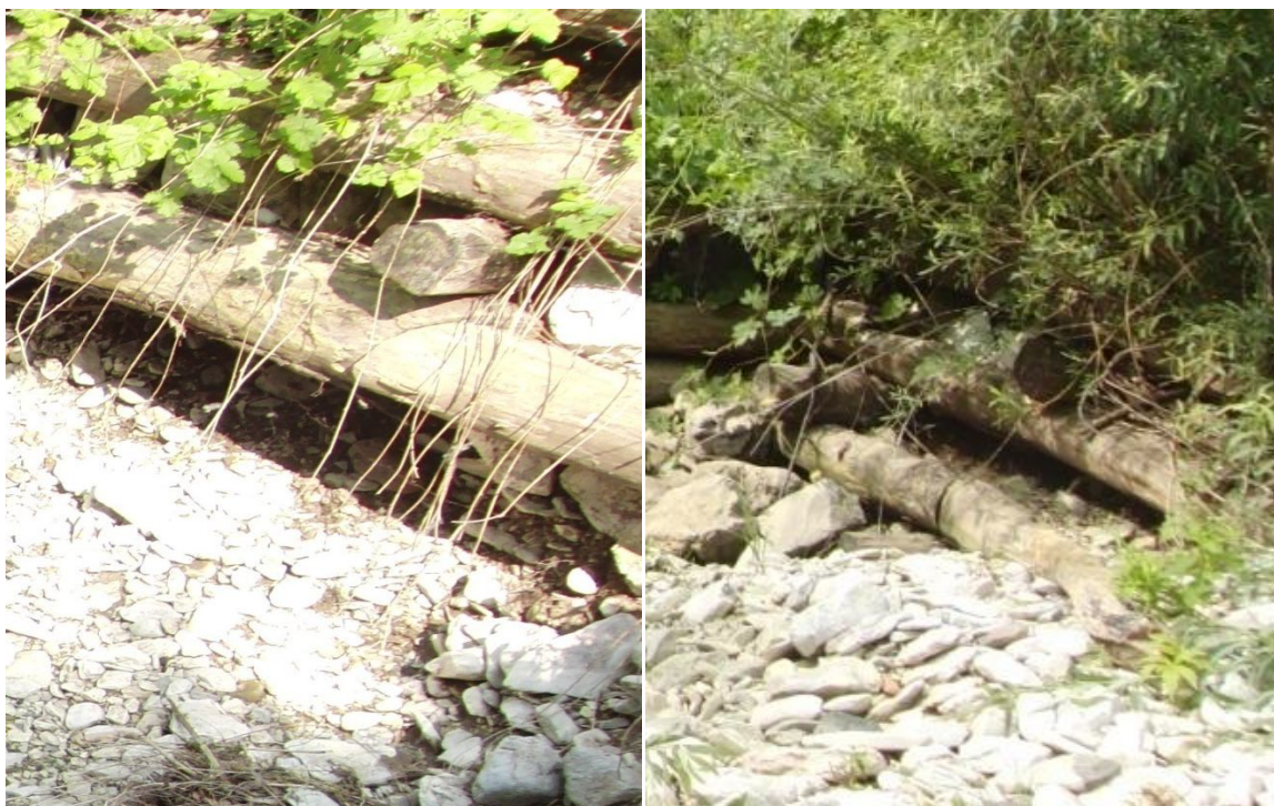
Fig. 4.4: Particolari della sottoescavazione e dello svuotamento sulle palificate nel torrente Livergon.
