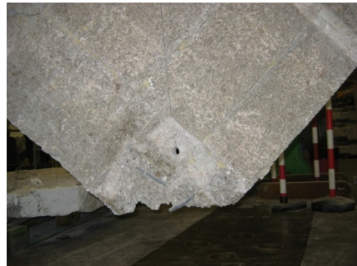
Figure 9-16. Local failure of panel n.16
