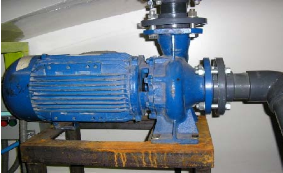
Fig. 4.14: la pompa centrifuga e il motore.
