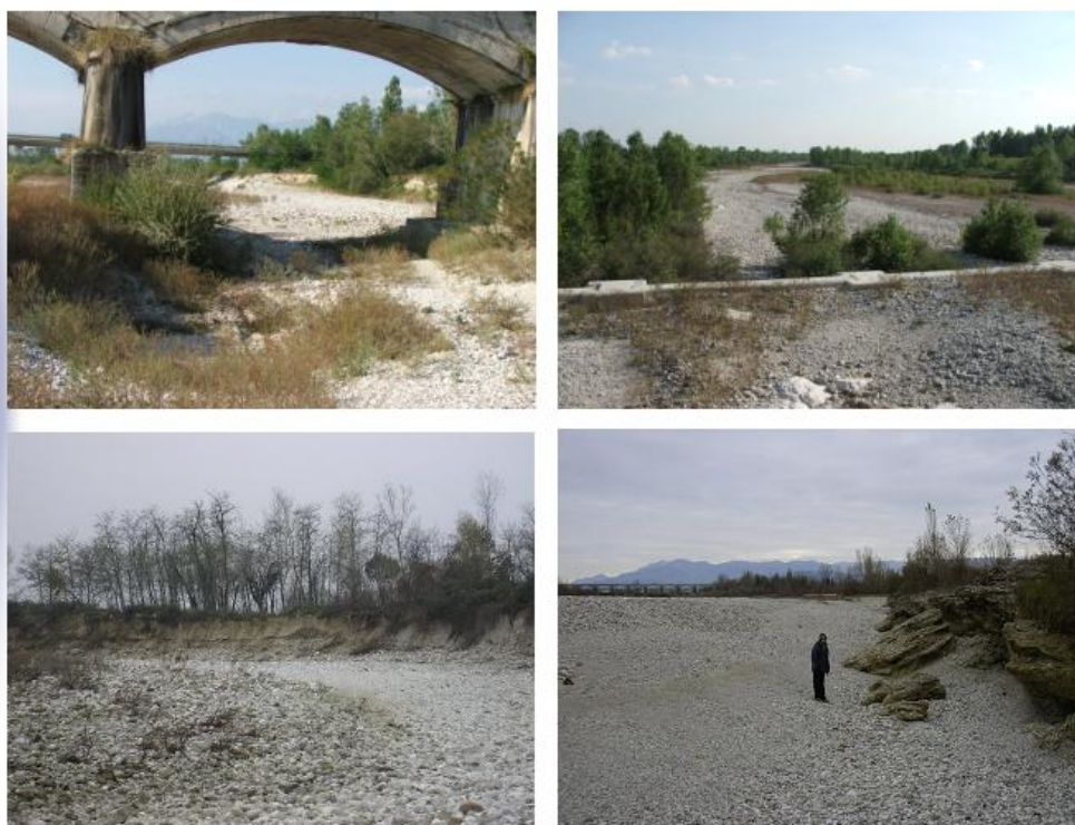
Figura 2.2 Tratto di studio: esempi di erosione nelle sponde e scalzamento alla base del ponte all'altezza di Gottardo.
