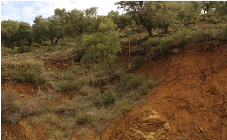
Particolare di fenomeni erosivi nella Sierra Morena cordobese. Foto personale.
