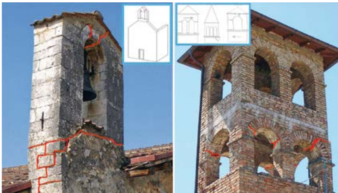
8. Fessurazione del campanile della Chiesa di Santa Giuliana a San Pellegrino (sinistra) e del campanile della Chiesa di Santa Giusta ad Amatrice (destra)
