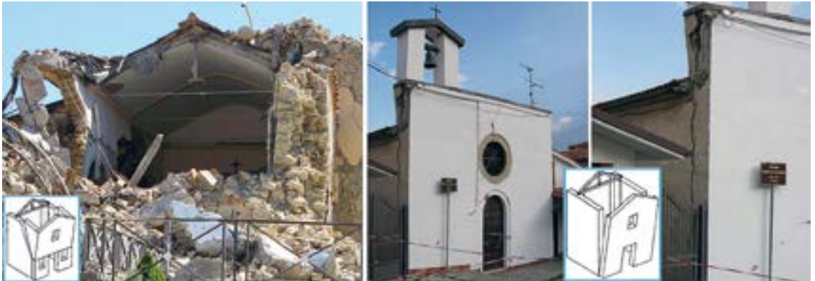
5. Ribaltamento della facciata della Chiesa di Santa Maria a Torrita (sinistra), innesco del ribaltamento della facciata della chiesa di Tino (destra)
