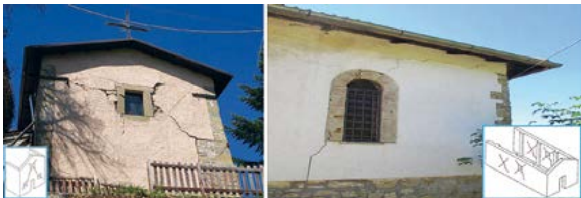
7. Meccanismi di taglio nella facciata della chiesa di Scai (sinistra) e nella parete laterale della chiesa di Colli (destra)
