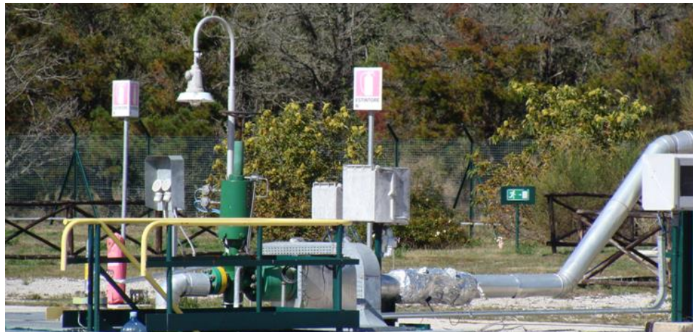
Fig. 2.9 Particolare della testa del pozzo Costa Molina 2, Montemurro (PZ)
