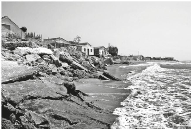
4.5 Spiãntza, case danneggiate nel segmento di Mouteli
