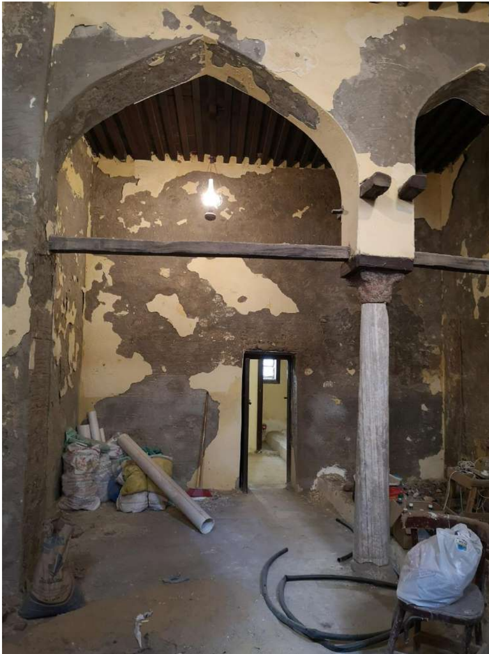
Fig. 5 Casa Amasili, piano terra, elementi del degrado
