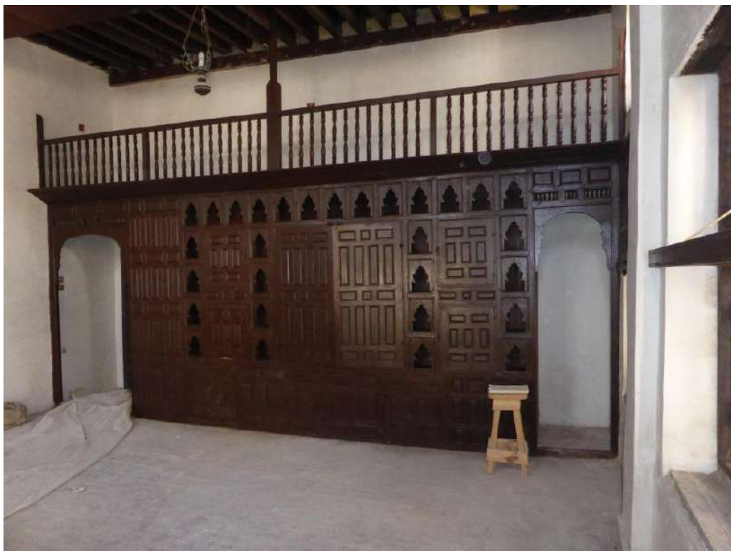
Fig. 32 Ultimazione di una delle stanze del secondo piano con intonaci e mobilio restaurati
