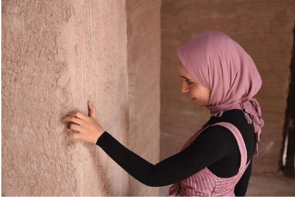
Fig. 27 Ispettrice al controllo della consistenza del nuovo intonaco grezzo di fondo dopo la fase di asciugatura
