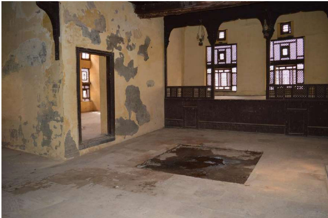
Fig. 17 Ingresso dell'acqua piovana dal lucernario privo di tetto
