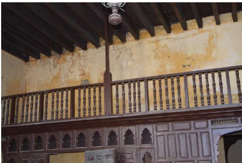
Figg. 6-8 Infiltrazione dell'acqua piovana dal tetto al secondo piano
