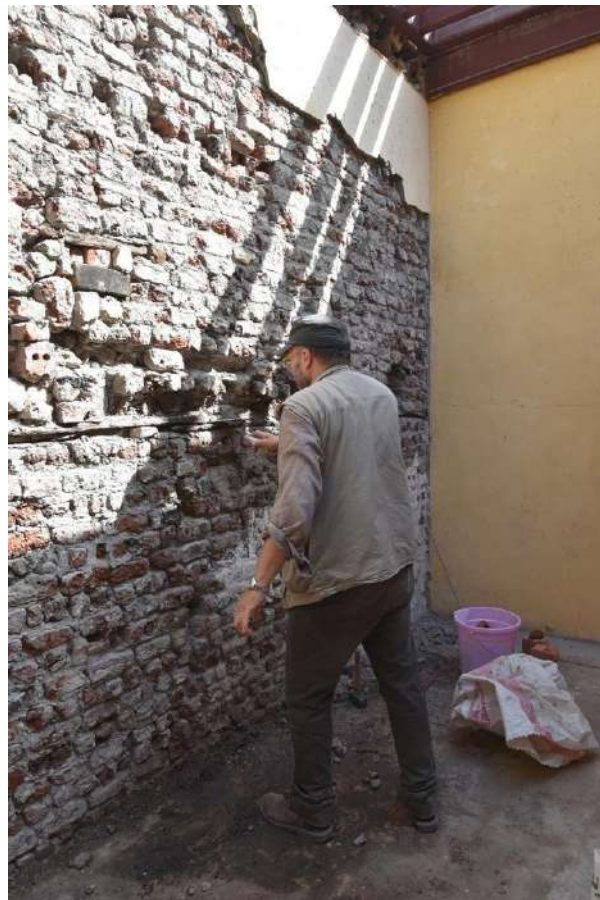
Fig. 24 Vista del muro più danneggiato al secondo piano e realizzazione del consolidamento
