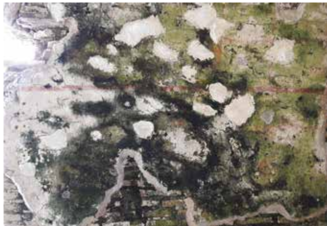
◆ Fig. 10.3. Caseggiato degli Aurighi. Ambiente 8, parete est. Stato della pittura nell'estate 2015 (foto C. Sbrolli).
