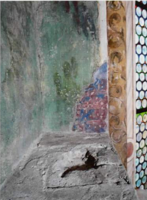
fig. 10.5 Cappella degli Scrovegni, abside, parete di fondo, base e spessore destro della nicchia
