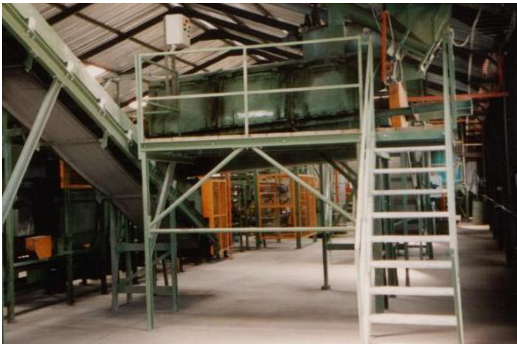
Figura 24 - Miscelatore lana di legno e cemento
