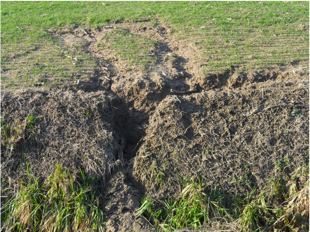
Figura 9: Erosione idrica originata da una non corretta regimazione delle acque meteoriche a seguito di errate lavorazioni tradizionali
