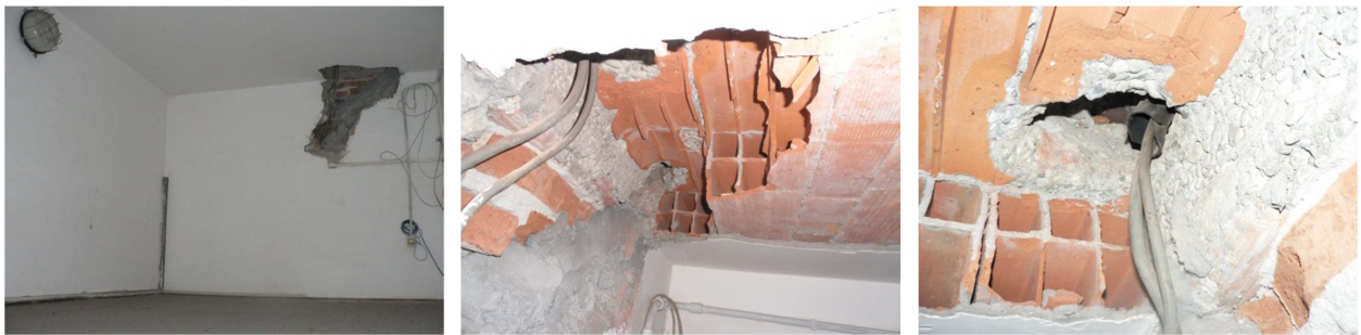
Figura 7.14: Identificazione delle caratteristiche del solaio in occasione di interventi impiantistici (tipologia e dimensione degli elementi, presenza del cordolo)
