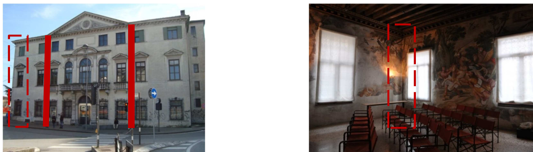
Figura 6.7: Elementi di vulnerabilità per l'attivazione del ribaltamento globale presenti nel palazzo Cavalli: presenza di aperture in prossimità delle pareti trasversali al prospetto principale:
