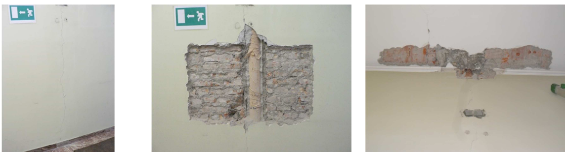
Figura 7.15: Individuazione della presenza di una discontinuità muraria dovuta da un giunto strutturale con interposto un elemento impiantistico
