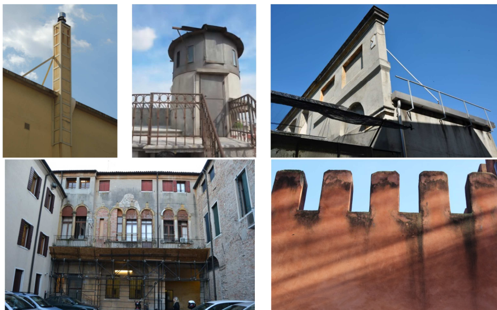
Figura 7.7: Elementi non strutturali fonte di vulnerabilità: componenti sporgenti o aggettanti
