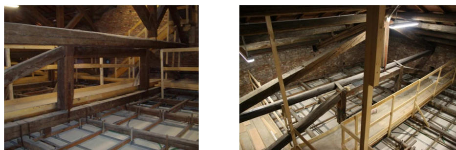
Figura 7.5: Elementi non strutturali di controsoffitto di nuova realizzazione ancorati alla struttura preesistente
