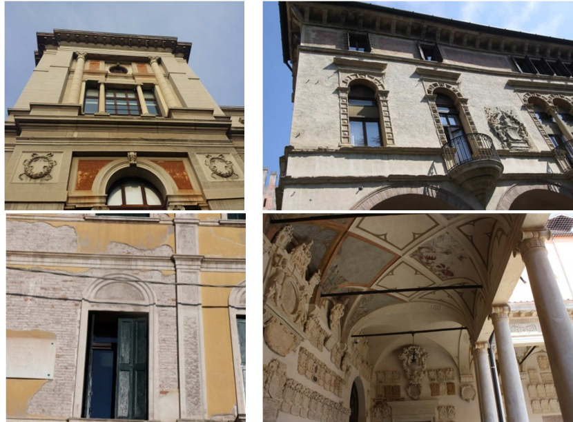
Figura 7.8: Elementi non strutturali fonte di vulnerabilità: componenti di finitura e decorazione
