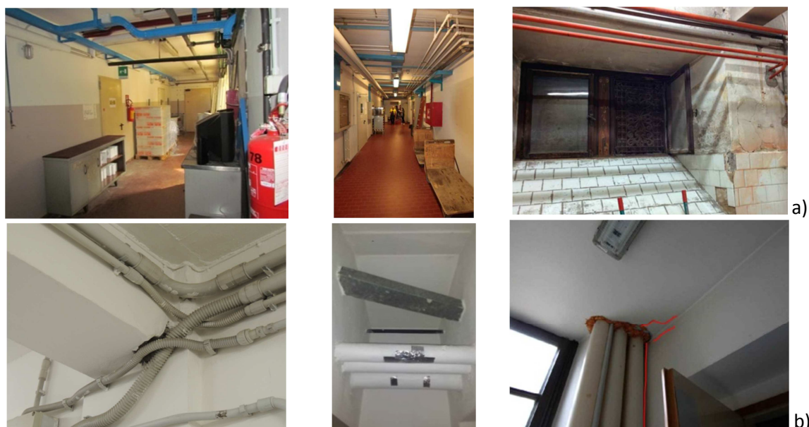
Figura 7.10: Esempio di elementi impiantistici rilevati a) "fuori traccia" e b) incidenti sulla struttura preesistente
