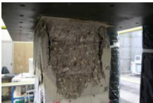
Figura 3.5: Quadro fessurativo delle colonne di controllo
