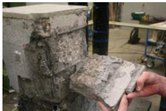
Figura 3.6: Quadro fessurativo delle colonne riparate con malta tipo a
