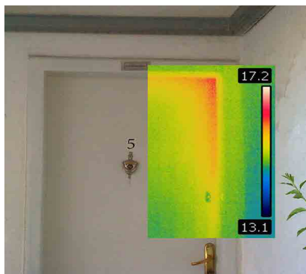
Figura 21. Dispersioni termiche dalla porta esterna
