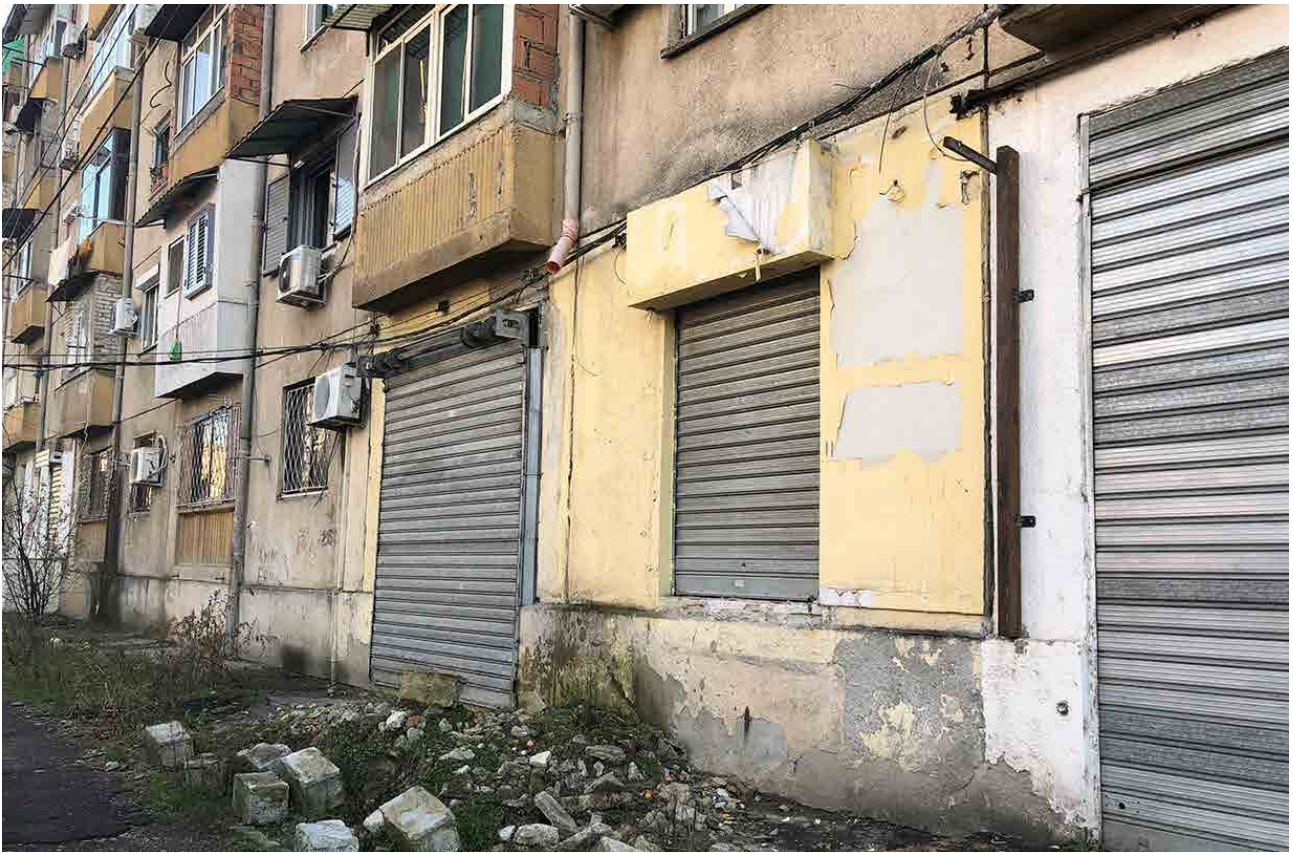
Figura 9. Danneggiamento del supporto dei pannelli sulla testata delle fondazioni
