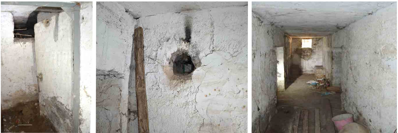
Figura 42. Aperture per l'aerazione/ventilazione dei rifugi, quartiere n.9 nella città di Tirana
