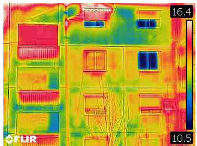
Figura 23. Dispersioni termiche della facciata con e senza isolamento. Rilievo del 12.01.2018 ore 15:00
