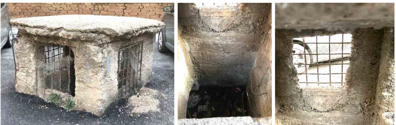
Figura 43. Boccaporti posizionati nel cortile che servivano anche come uscita di emergenza, quartiere Porcelani nella città di Tirana
