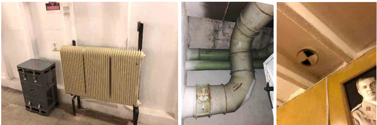
Figura 36. (a) Elemento per la produzione dell'ossigeno, (b) tubazioni del sistema di aerazione, (c) sistema d'aspirazione nel rifugio antiatomico di Linz "BunkArt 1" nella città di Tirana
