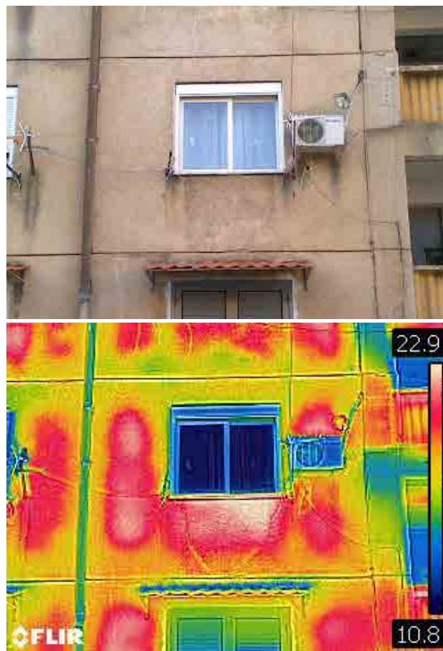
Figura 15. Ponti termici nella facciata esposta a Nord. Rilievo del 12.01.2018 ore 14:00
