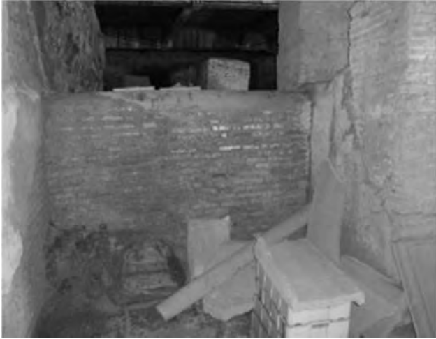
Muro di tamponatura del portico, aggiunto in una seconda fase, addossato ai pilastri (e all'intonaco di rivestimento).
