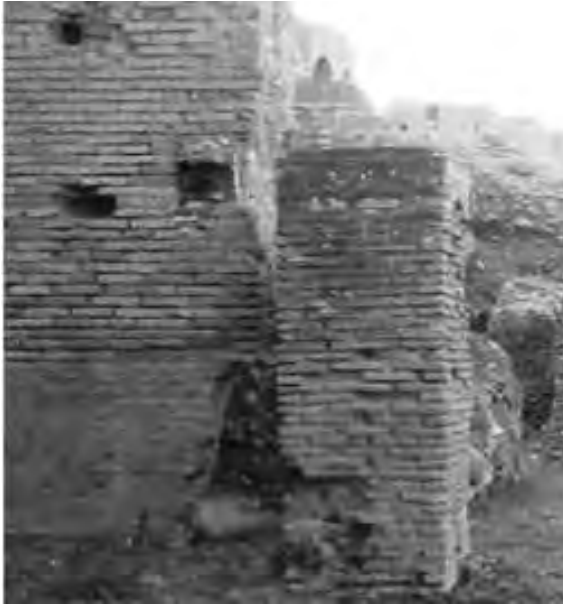
Pilastro in opera cementizia con cortina laterizia, costruito in età severiana nel vano 73.
