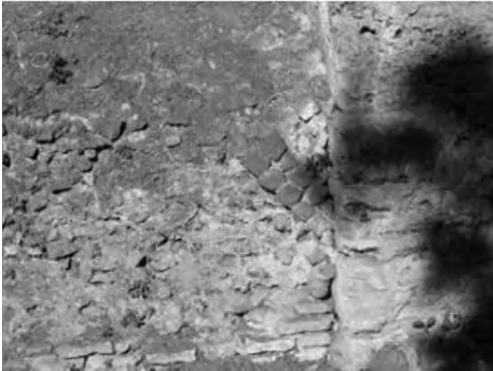
Muri divisorio, tra la cella 6 e 7, in conglomerato e opera mista, addossato al pilastro in blocchi di travertino.
