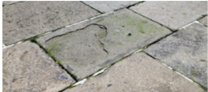
Fig. 28 – Padova, piazza Insurrezione. Lastra in trachite soggetta a degradazione centrale (foto autore, febbraio 2015).
