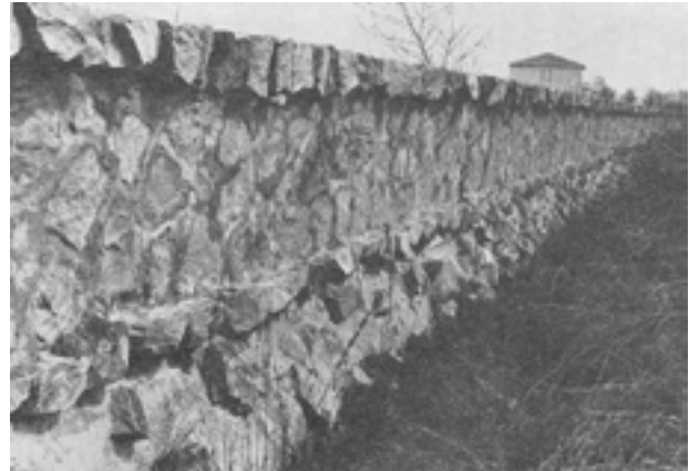
Fig. 32 – Cavallino-Treporti (VE), diga interna a difesa dell'abitato in scapoli di trachite di Monte Merlo (da CALVINO 1969, fig. 6, p. 27).
