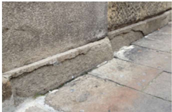
Fig. 29 – Padova, via Santa Lucia. Zoccolo di edificio in trachite soggetto a degrado (foto autore, febbraio 2015).
