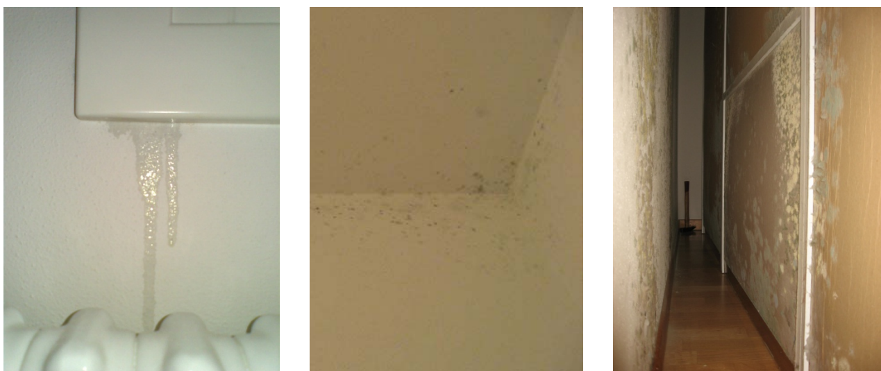
Figura 30. Infiltrazioni di acqua, muffa nel soffitto e nelle pareti, muffa nella parete e nell'armadio.
