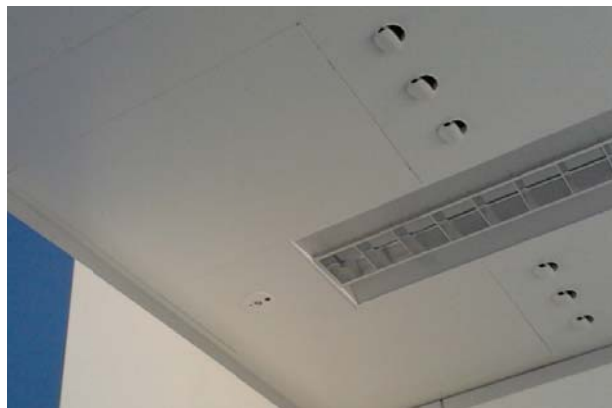
Figura 77. Ugelli tangenziali posizionati vicino all'ingresso dell'ufficio.
