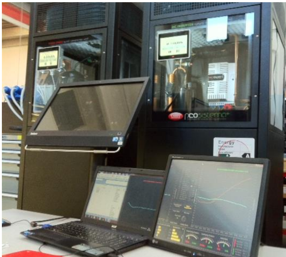
Fig. 3.13 – Foto dell'unità refrigerante aria-acqua on-off (sulla sinistra) e dell'unità con compressore a velocità variabile (sulla destra) utilizzate nei test sperimentali.
