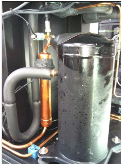
Fig. 2.11 – Esempio di brinamento della carcassa del compressore, provocato dall'aspirazione di refrigerante liquido nei test effettuati con apertura iniziale della valvola EEV 90%.
