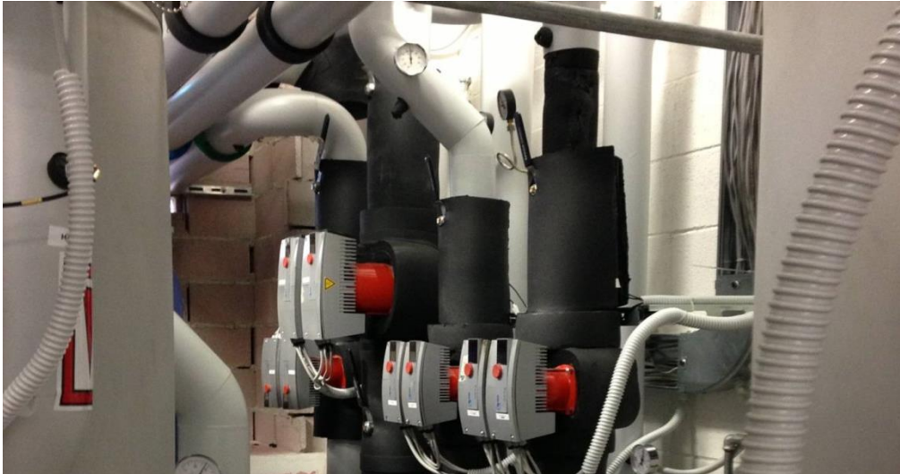
Fig. 4.7 – Foto delle pompe di circolazione a velocità variabile (con inverter) dell'anello d'acqua.
