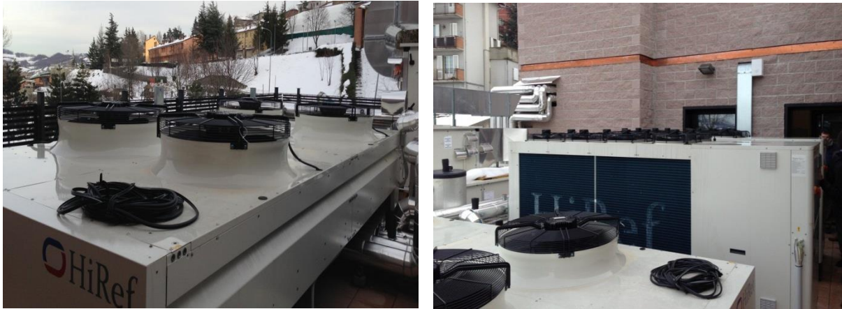
Fig. 4.6 – Foto dell’unità polivalente chiller/pompa di calore (sulla destra) e del dry-cooler (sulla sinistra) posizionati sul tetto del supermercato WLSC.
