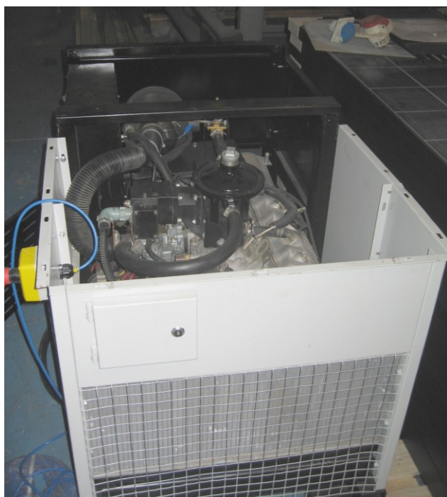
Figura 4-32 Gruppo di produzione di energia elettrica installato
