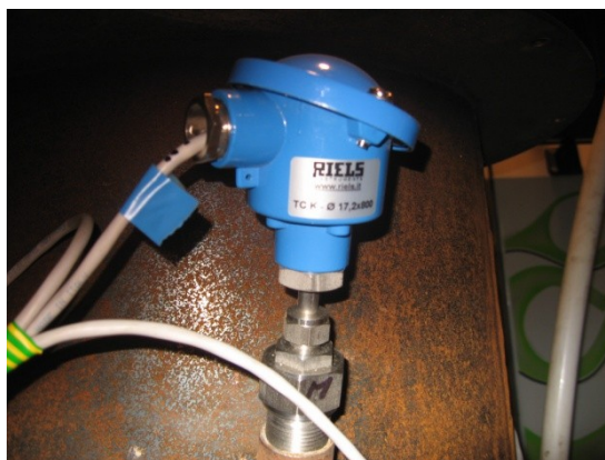
Figura 4-35 Particolare sonda di temperatura inserita nel reattore di gassificazione
