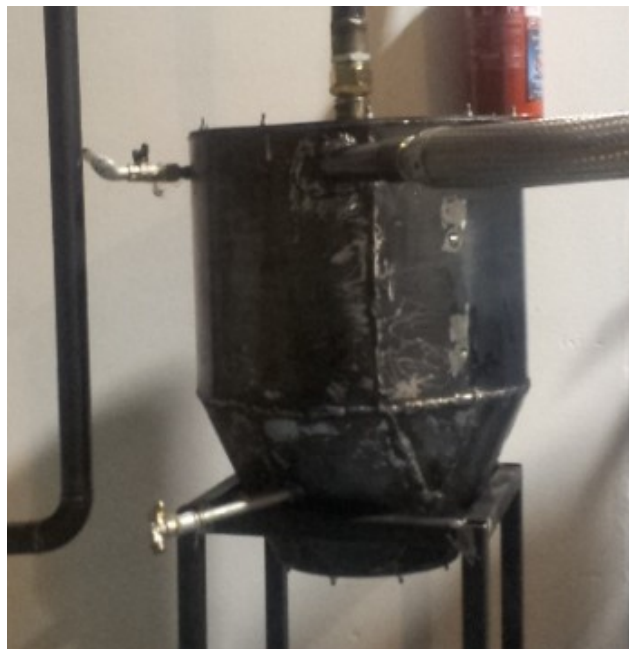
Figura 4-30 Sistema di filtrazione e raffreddamento del syngas
