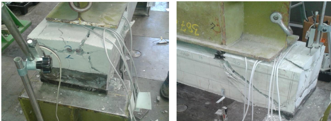
Figura 4.53 e 4.54: Quadro fessurativo TRR Serie
