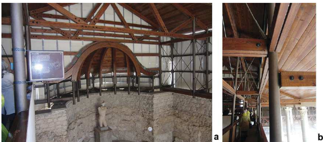
Figura 6.32: Nuova musealizzazione della villa del Casale: a) vista dell'abside della basilica; b) dettaglio della struttura in acciaio e legno
