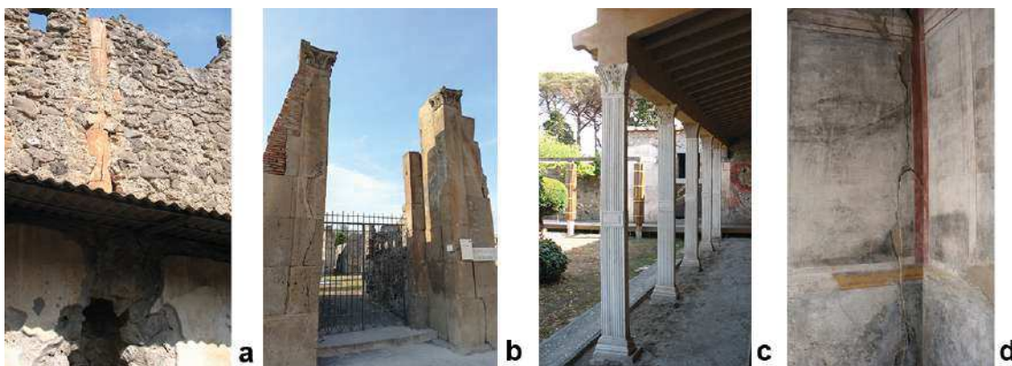
Figura 2.17: Alcuni elementi di vulnerabilità strutturale individuabili a Pompei: a) “tracce impiantistiche” nelle murature (cadute di antichi pluviali in terracotta); b) elementi murari snelli e non collegati; c) elementi verticali snelli; d) mancanza di ammorsamento ai martelli murari
