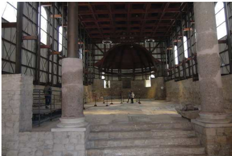
Figura 5.23: Vista interna della basilica della Villa del Casale nella recente veste museale che ha sostituito l'intervento di Minissi degli anni '50
