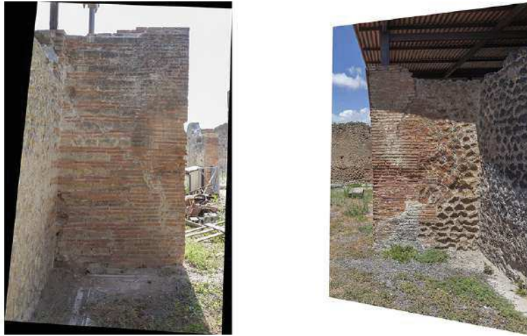
Figura 9.1: Evidenze del danno sismico nelle domus delle Terme del Sarno. La buona qualità dell'ammorsamento tra muri è testimoniato dalla lesione ad andamento diagonale nella parete invece di sub-verticale presso l'innesto tra pareti ortogonali. Si nota inoltre la presenza delle catene angolari nell'opera reticolata e la prosecuzione nell'angolata delle assise di mattoni dell'opera vittata mista
