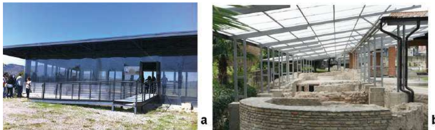
Figura 6.28: Inadeguato confinamento laterale dovuto a: a) eccessiva superficie vetrata anche se compensata da un pronunciato aggetto di gronda (da [57]); b) completa assenza della parete verticale (da [58])
