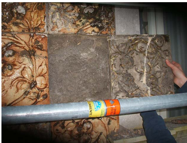
Fig.4.1.2.3: piastrelle con lavorazione a bassorilievo raffiguranti i rami con mele selvatiche, il cui colore è alterato dalla presenza di una patina biologica di colore scuro riconducibile alla presenza di funghi e batteri.
