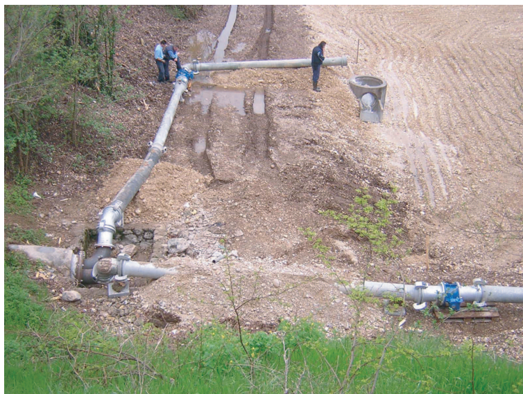
Figura 2.39: Tubazioni di adduzione alle vasche.
