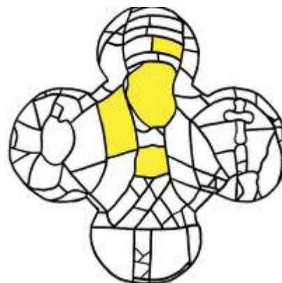
Rilievo del fenomeno di distacco delle grisaglie
