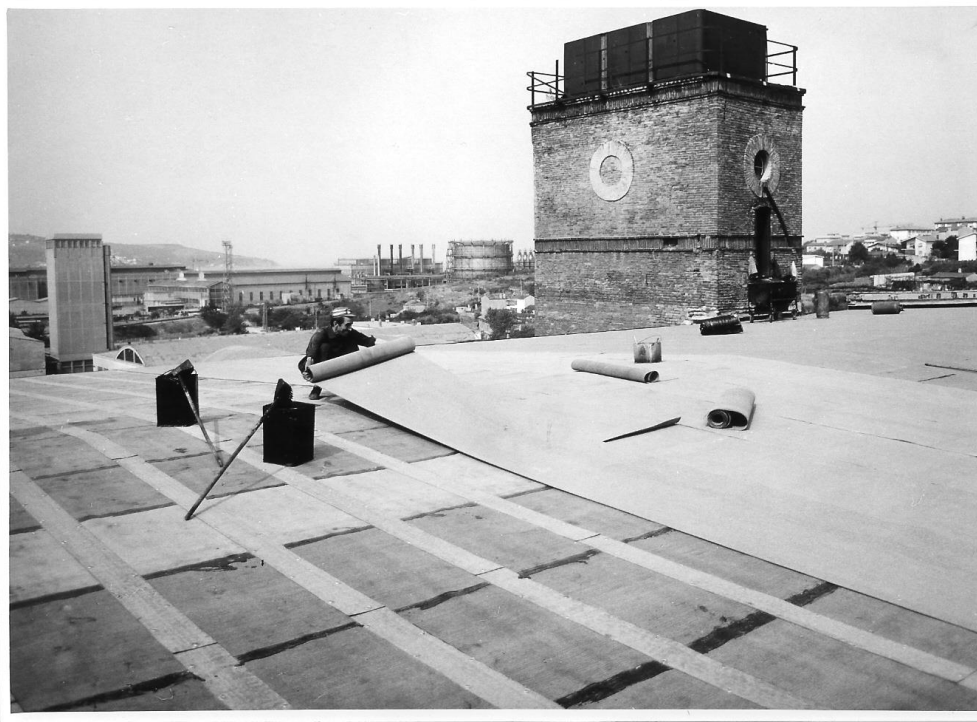
Fig. 17 – Lavori di trasformazione della Risiera di San Sabba in Museo della Resistenza (Archivio storico del Civico Museo della Risiera di San Sabba, Trieste).
