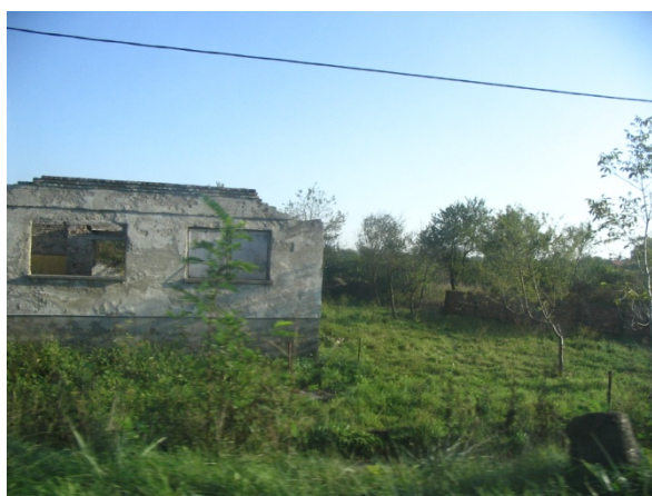
Fig. 8. 13 – Edifici distrutti lungo la strada dal confine croato-bosniaco a Derventa (foto: Brusarosco A., 2007).
