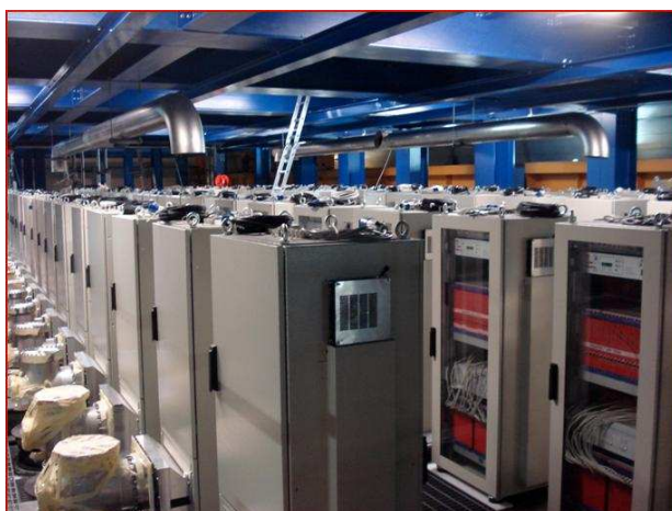
Figura 1.3: Armadi dell'elettronica di acquisizione di ICARUS T600 installati sul tetto del rivelatore.
