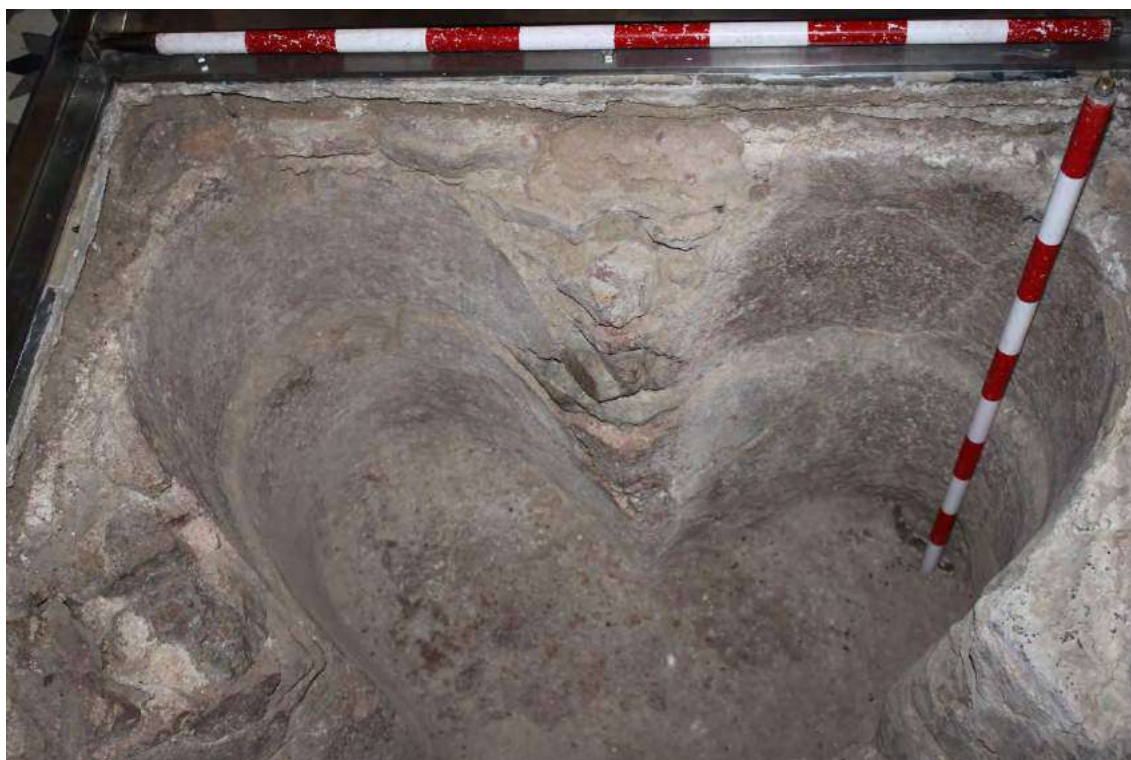
Fig. 4. Detalle del recrecido en ladrillo en el baptisterio de la ermita de la Virgen de las Cruces.
