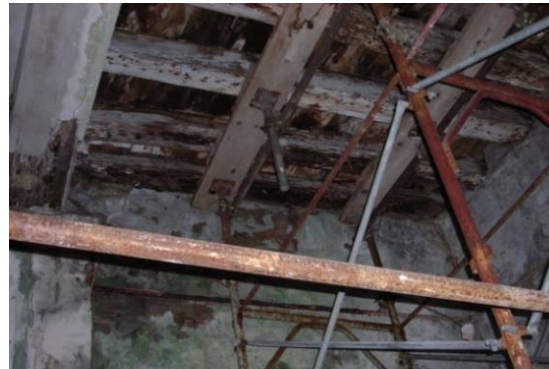
Fig. 4.4.27: Decay edge beam
