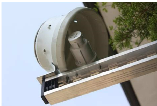
Figura 19 - Dettaglio protezione solare su sonde esterne
