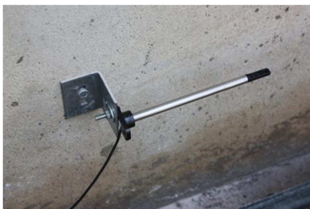
Figura 21 - Dettaglio posizionamento sonda anemometrica
