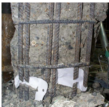
figura 2.91 – Rottura delle barre di armatura longitudinali al termine del ciclo n°8 (ampiezza 120.00mm) [2.22]
