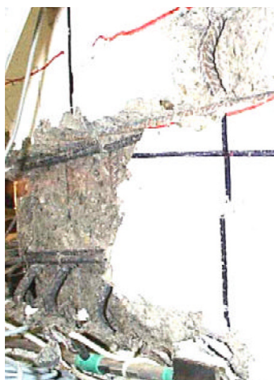
figura 2.106 – Rottura delle staffe e buckling delle barre longitudinali al termine del ciclo n°8 (ampiezza 120.00 mm) [2.23]
