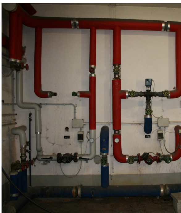
Figura 87- Particolare del locale caldaia
