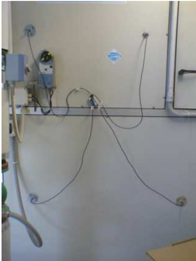
Figura 99 – Sistema di misura delle temperature nel recuperatore UTA C3
