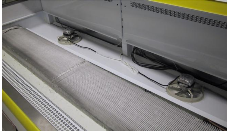
Figura 2.3.8 – Evaporatore con ventilatori originali.
