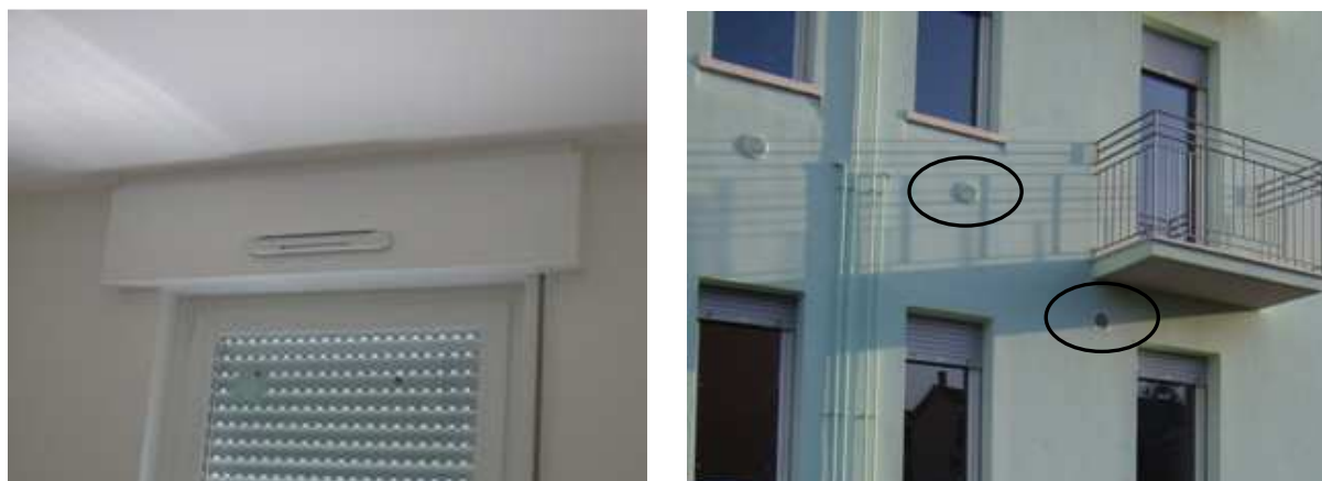
Figura 14 – Immagine di un ingresso d'aria igroregolabile su un cassonetto dell'avvolgibile (a sinistra) e vista esterna della facciata dei soggiorni-cucina in cui si vedono sia il foro di aerazione che quello per la ventilazione meccanica
