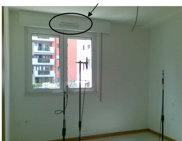
Figura 12 – Immagine di una delle finestre della palazzina D. È presente un ingresso d'aria e sul cassonetto dell'avvolgibile
