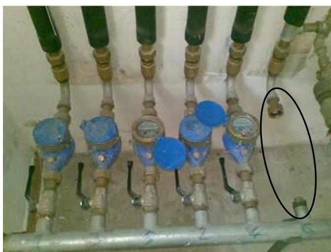
Figura 13 – Immagine dei contatori dell'acqua della palazzina D2 al momento dei collaudi: era assente uno dei contatori.
